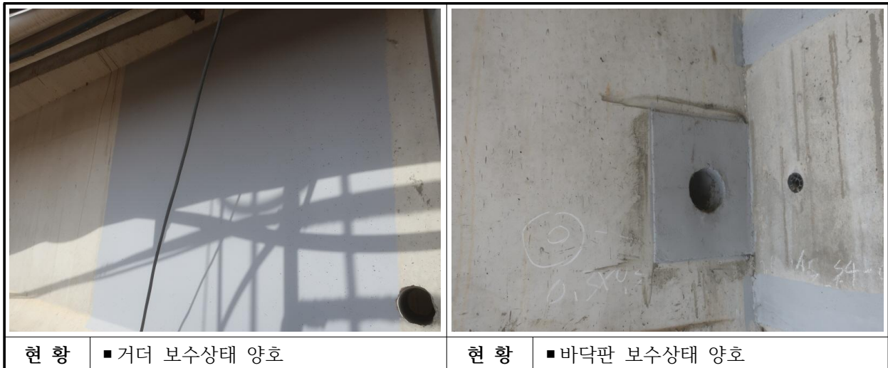
【그림 2.8】 북삼교 거더 손상사진 (2/2)
