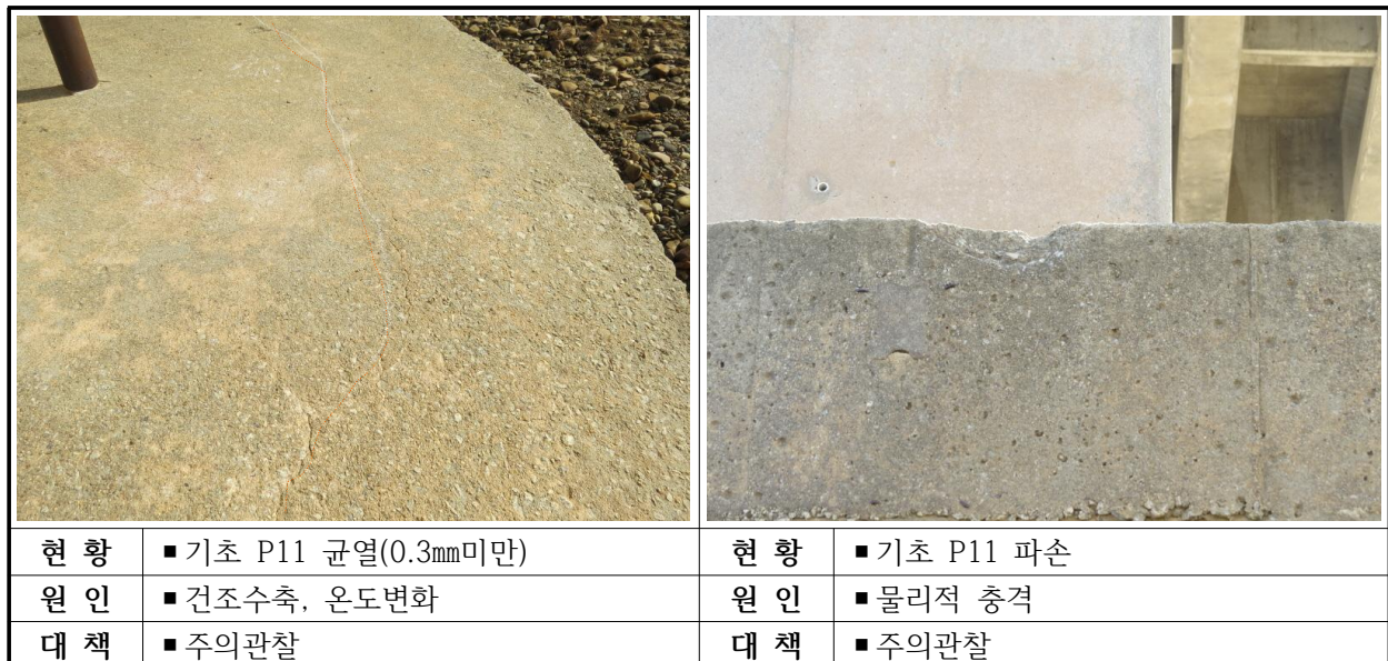
【그림 2.20】 북삼교 교대 손상 사진
