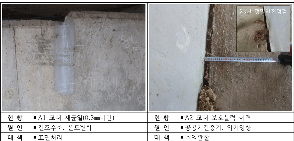
【그림 2.12】 북삼교 교대 손상 사진
